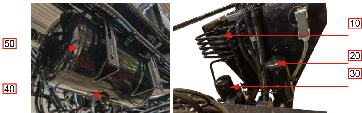
34. ábra Sűrített levegős rendszer DT 3500H
